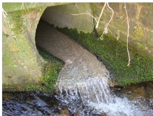
Egout se déversant directement
